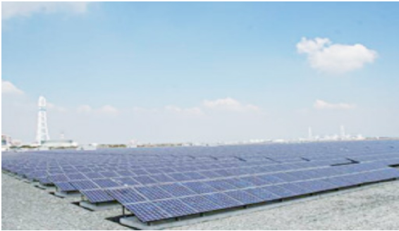
中部電力武豊火力発電所内のメガソーラー 発電出力7500kwの中部地域最大級の大規模太陽光発電所
